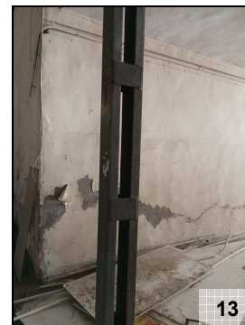
Fotografía nº 13: Vista del alzado de un pilar de la alineación lateral de la nave de mayor luz (2 UPN-140 (d=20cm) empresillados).
