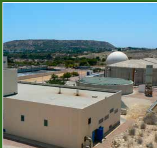
EDAR Mont Orgègia
