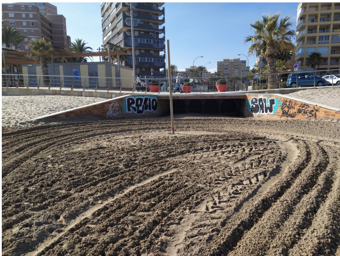
Imagen 3. Aliviadero acceso nº9 de la Playa de San Juan. Fecha: 17/11/20. Inteligencia Climática.
