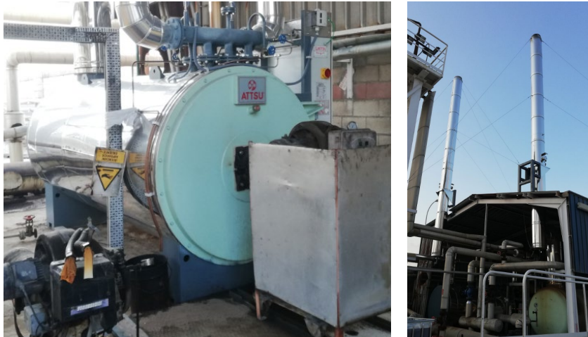
FOTO 7. Caldera nueva y chimeneas
