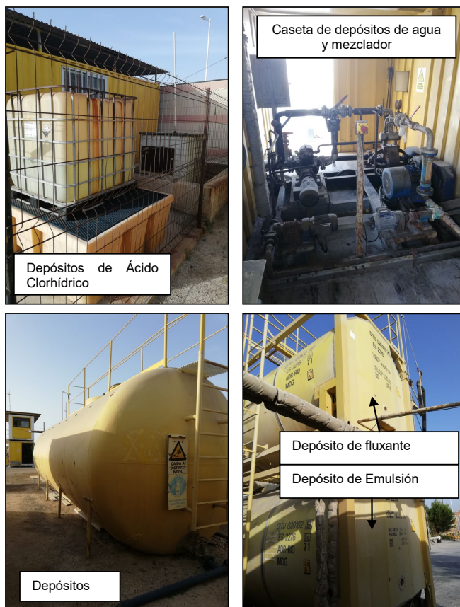
FOTO 4. Planta de emulsiones asfálticas
