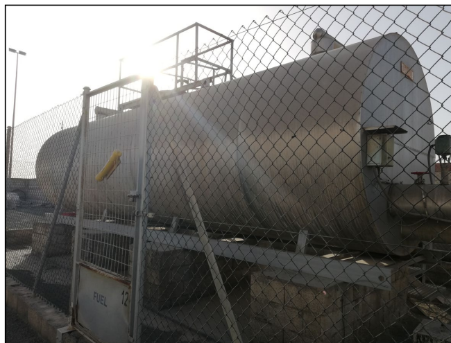
FOTO 3. Tanque de almacenamiento de gasóleo 1 (30 m 3 ).
