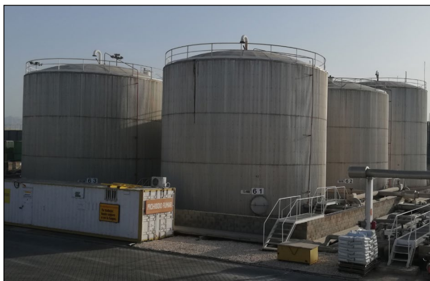
FOTO 1. Tanques de almacenamiento de betún base
