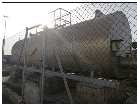
FOTO 2. Tanque de almacenamiento de fuelóleo
