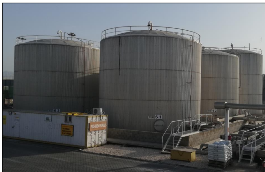
FOTO 1. Tanques de almacenamiento de betún base
