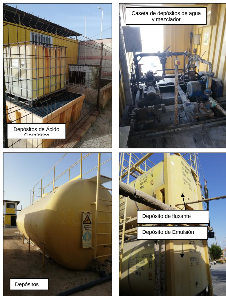
FOTO 4. Planta de emulsiones asfálticas
