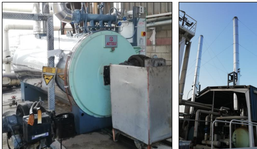
FOTO 7. Caldera nueva y chimeneas
