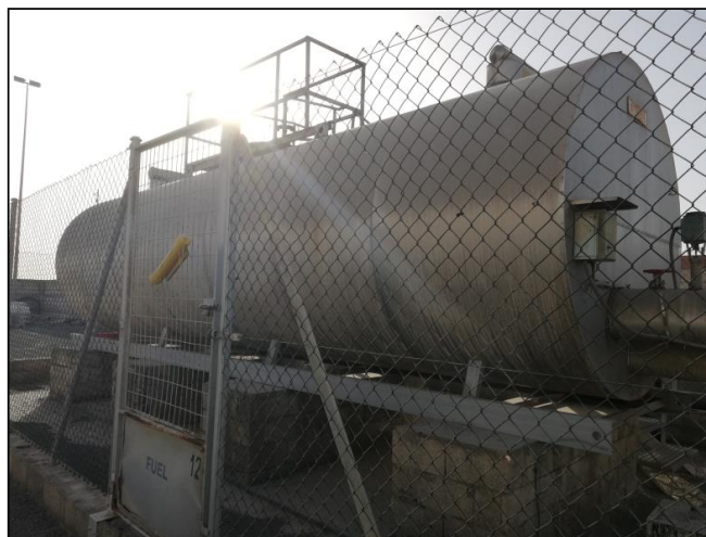
FOTO 2. Tanque de almacenamiento de gasóleo 1 (30 m 3 ).
