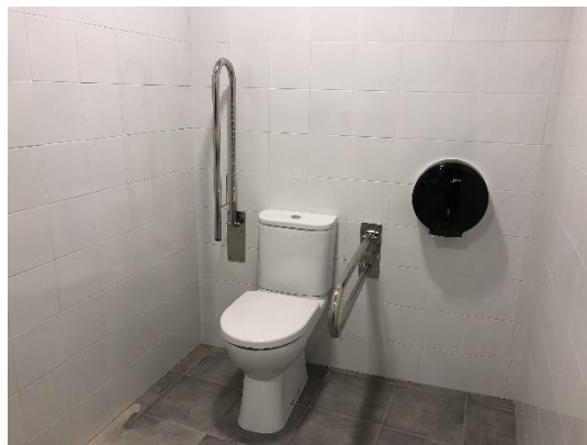
Inodoro con barras de apoyo laterales.
