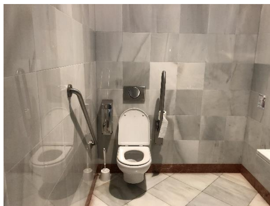
Inodoro con barras de apoyo laterales.
