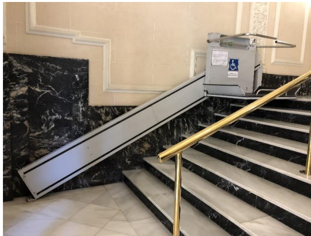
Salvaescaleras de acceso a la planta principal del Palacio Provincial de la Diputación de Alicante.
