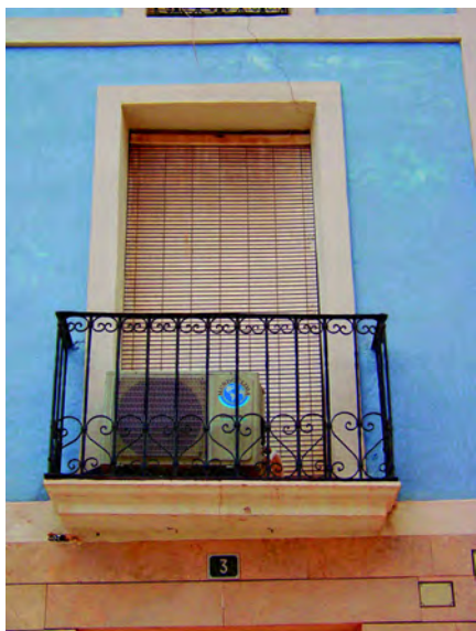
Balcón. Aire acondicionado elemento impropio.
