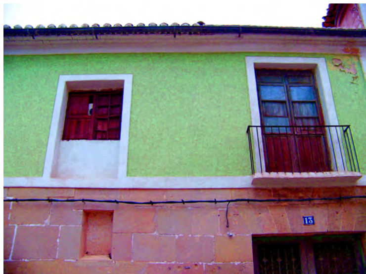
Carpintería en mal estado.
