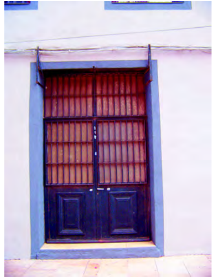
Carpintería metálica. Impropio.
