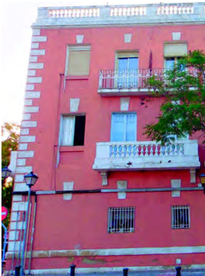
Huecos reducidos. Carpintería metálica. Impropio.
