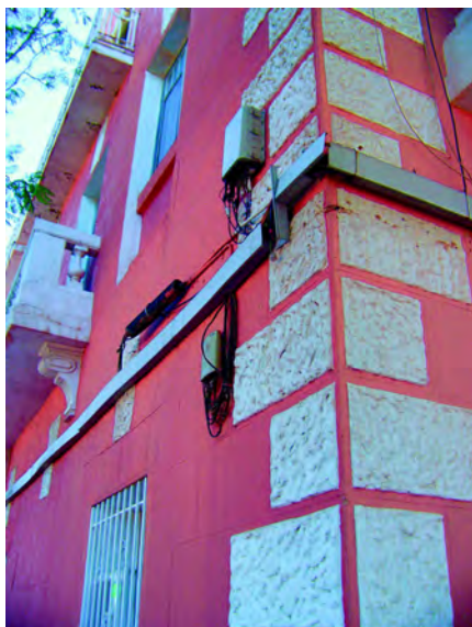
Instalaciones en fachada. Impropio.
