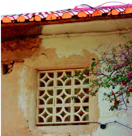
Celosía hueco y panel sandwich. Impropio.
