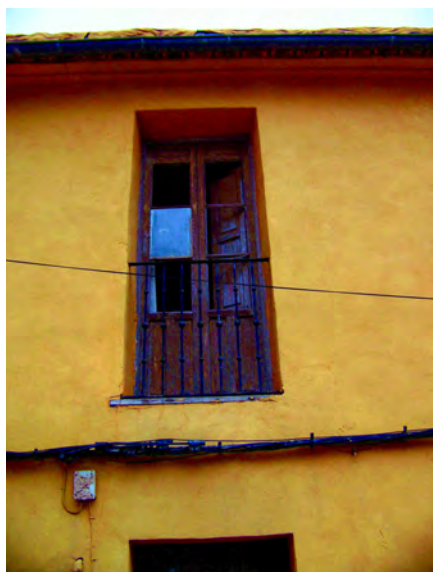
Carpintería en mal estado.
