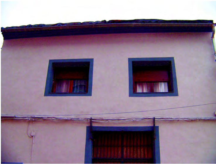
Carpintería de PVC o metálica. Impropio.
