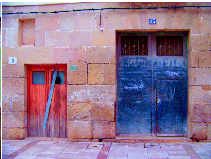
Carpintería en mal estado.
