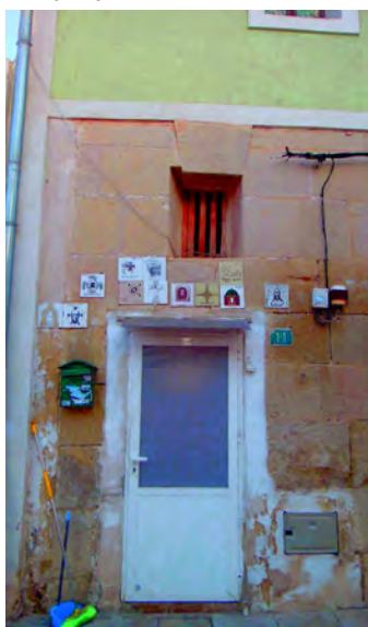
Carpintería PVC o metálica. Impropio.
