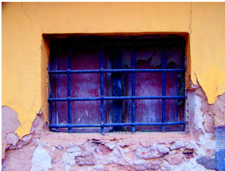
Cerrajería de forja. Muro en mal estado.
